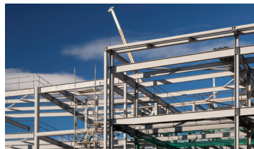
Structures en acier
